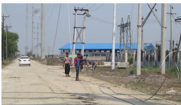
ヤンゴンの工業団地では送電線の張り替え作業が進む。電力事情も急速に改善中だ
